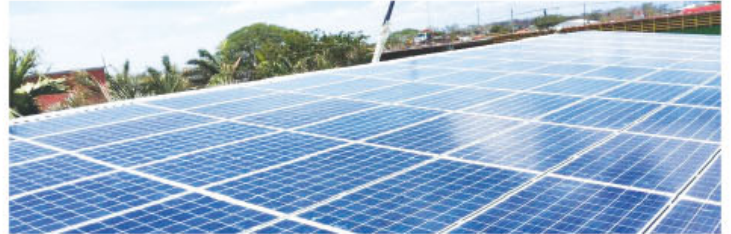
Así lucen los paneles solares del Hotel Caña Brava en Cañas.
