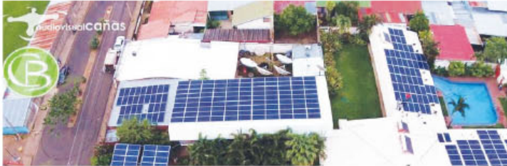
Más de 450 paneles ubicados en el techo de hotel convierten los rayos solares en casi 20 mil KW hora por mes.
